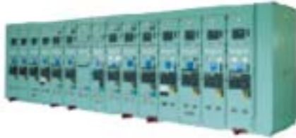
配電制御システム（発電機自動化装置）
