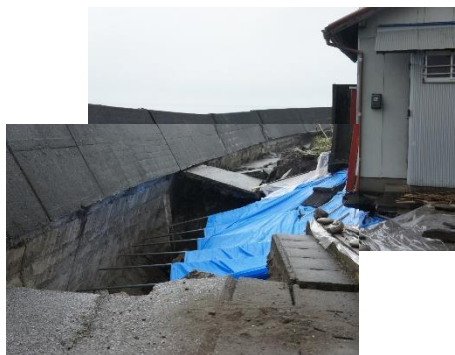
Fig.1 防潮堤の裏込め土が流出し、空洞を形成・陥没
